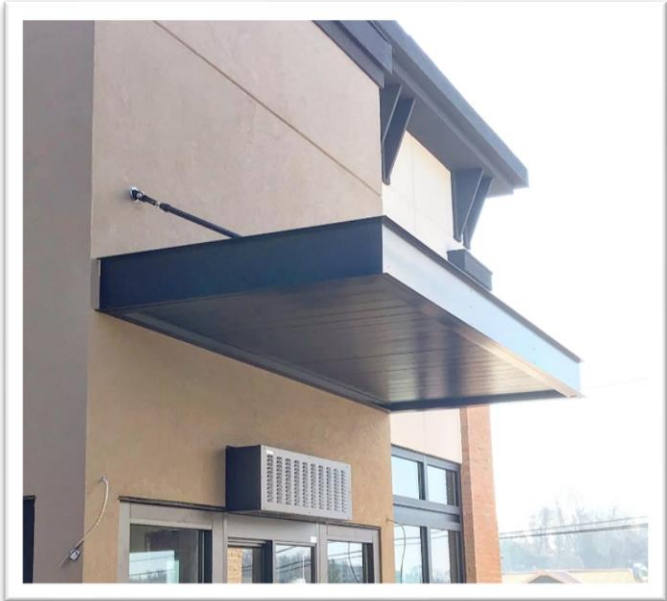
Mapes Hanger Rod Canopy
